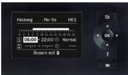
Vitotronic Regelung – klare Anzeige der Schaltzeiten
